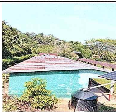
Foto 4: se necesita pintar el edificio
